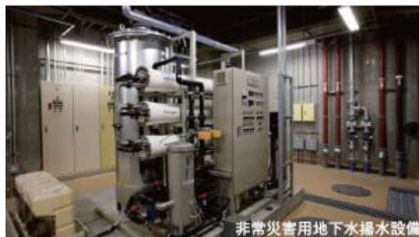
非常災害用地下水揚水設備の事例
